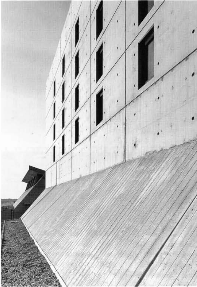
De schuin-oplopende vlakken vertonen de textuur van ruwe houten delen; de verticale vlakken zijn glad met een patroon van centerpen-gaten en naden van bekistingsplaten
